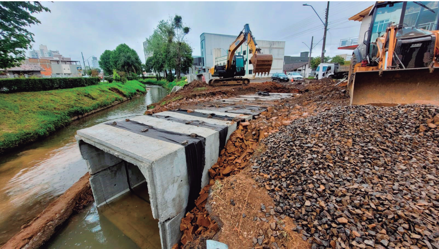
Galeria escoar água do interior do Bairro São Cristóvão para o Rio Carahá
