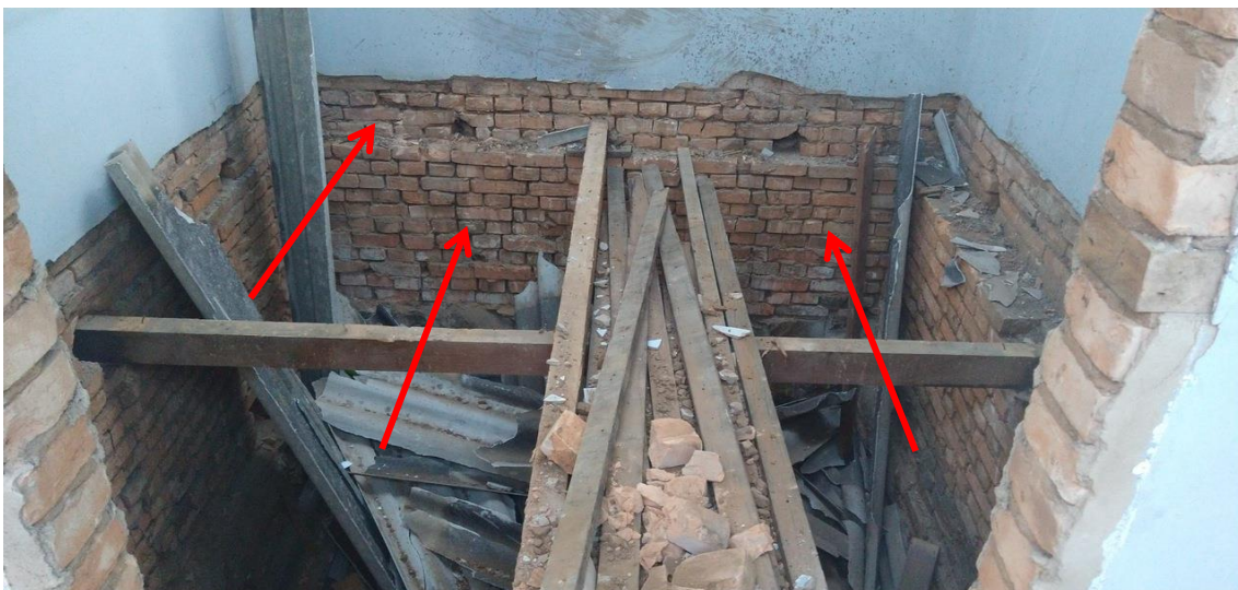
Figura 02 – Tomada fotogr fica em que pode se observar: Assoalho removido onde observamos pontos de fissuras devido problemas de estabilidade pr -existentes na estabilidade global da casa, indicadas pelas setas vermelhas.
