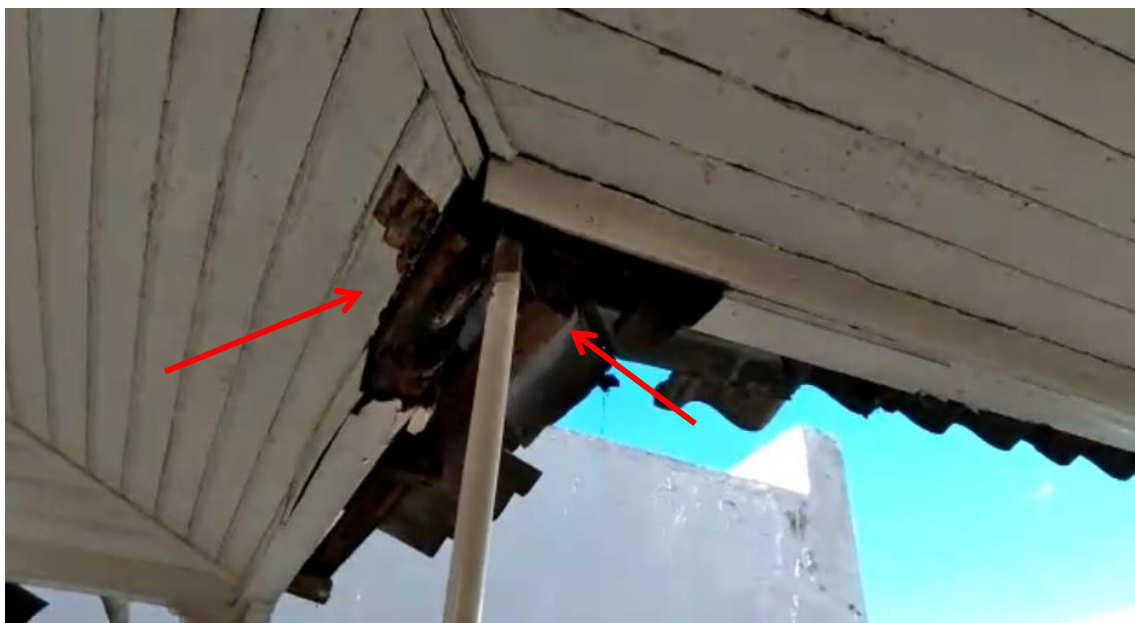
Figura 11– Tomada fotográfica em que pode se a estrutura da cobertura com comprometimento estrutural da madeira avariada pelo tempo com risco de colapso, indicadas pelas setas vermelhas
