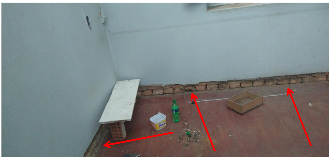
Figura 03 – Tomada fotogr fica em que pode se observar: Encontro do assoalho com a parede, de observamos pontos de fissuras devido a idade da edifica o demonstrando falta de estabilidade global da casa, indicadas pelas setas vermelhas.
