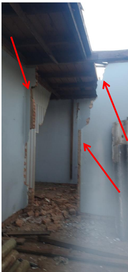
Figura 01 – Tomada fotográfica em que pode se observar: parede de alvenaria de tijolos maciços com função estrutural, demolida afetando a estabilidade global da casa, indicadas pelas setas vermelhas.
