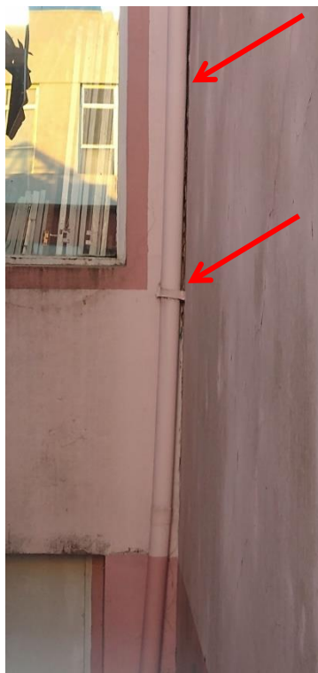
Figura 06 – Tomada fotográfica em que pode se observar movimentação e descolamento da parede , afetando a estabilidade global da casa, indicadas pelas setas vermelhas.
