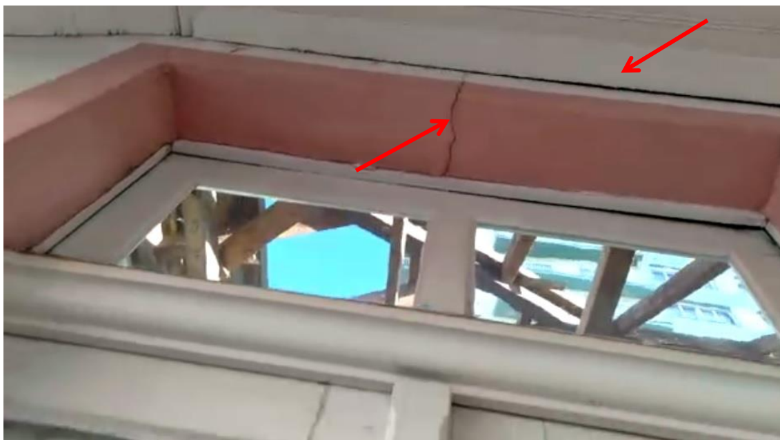
Figura 07 – Tomada fotográfica em que pode se observar trincas nas aberturas causado pela falta estabilidade global da casa, indicadas pelas setas vermelhas.
