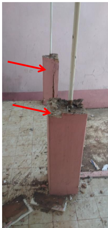
Figura 05 – Tomada fotográfica em que pode se observar pilares demolidos parcialmente, afetando a estabilidade global da casa, indicadas pelas setas vermelhas.
