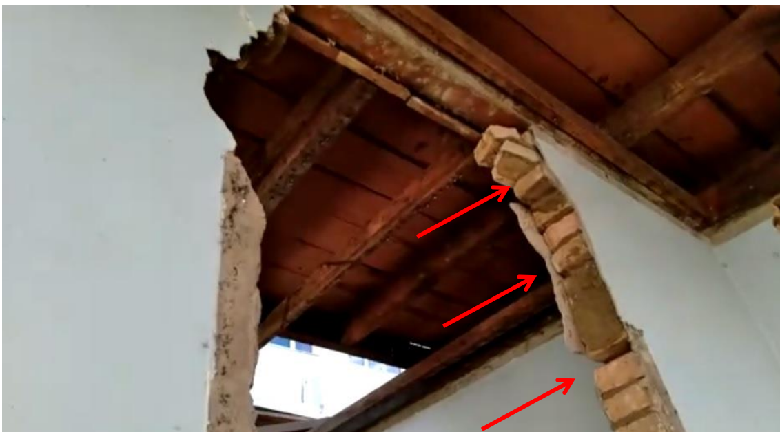
Figura 08– Tomada fotográfica em que pode se a estrutura das paredes com comprometimento estrutural , sem condições de serem reparadas, indicadas pelas setas vermelhas.
