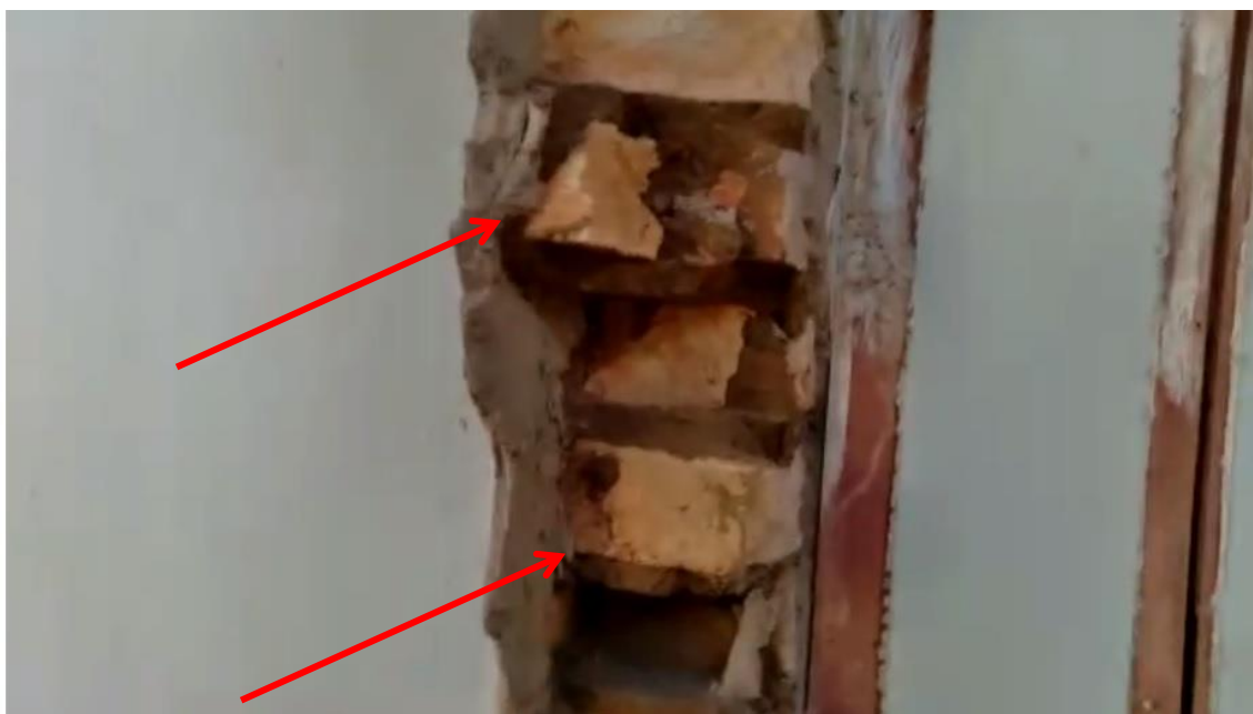
Figura 09– Tomada fotográfica em que pode se a estrutura das paredes com comprometimento estrutural , sem condições de serem reparadas, indicadas pelas setas vermelhas
