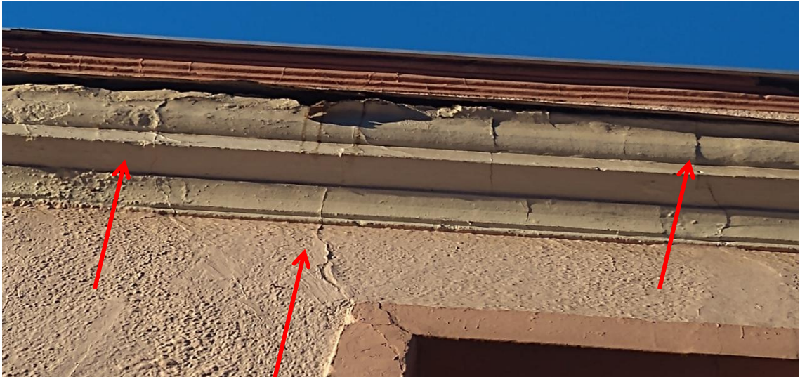
Figura 04 – Tomada fotográfica em que pode se observar: fissuras causadas pelo processo da passagem do tempo, demonstrando falta de estabilidade global da casa, indicadas pelas setas vermelhas.
