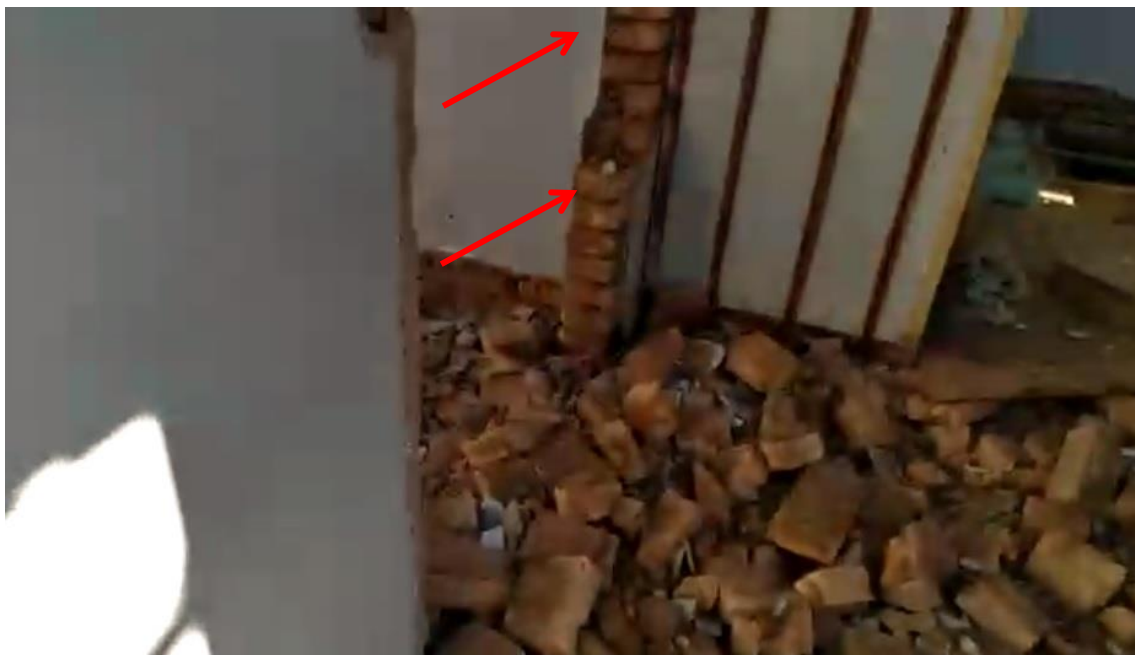
Figura 10– Tomada fotográfica em que pode se a estrutura das paredes com comprometimento estrutural , sem condições de serem reparadas, indicadas pelas setas vermelhas
